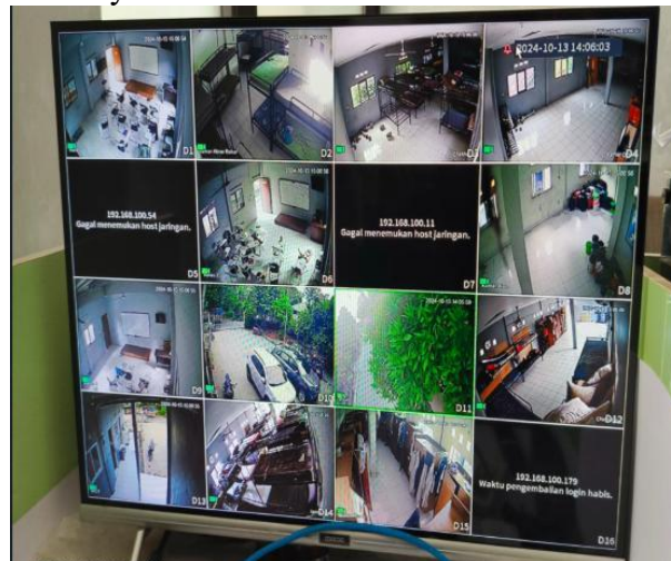
Gambar 1 kondisi CCTV yang tidak tampil
