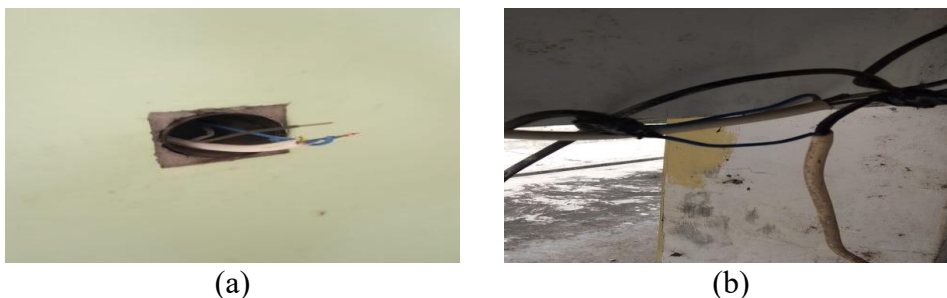
(a) (b) Gambar 4 Kondisi (a) MCB dan (b) kabel sebelum pelaksanaan PkM
