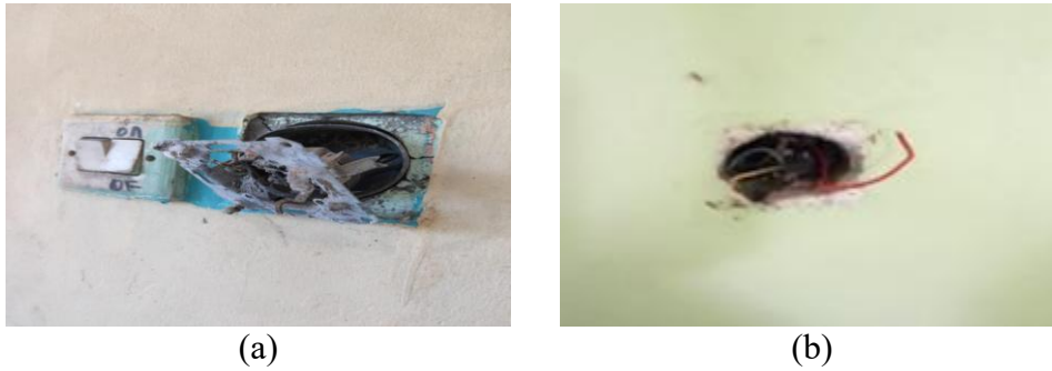
Gambar 2 Kondisi (a) saklar dan (b) stop kontak sebelum pelaksanaan PkM
