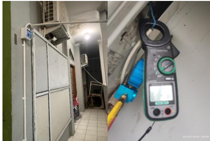
Gambar 4 Pengoperasian lampu emergency dan AC Split
