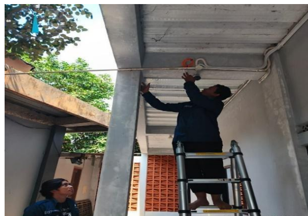
Gambar 2 observasi dan pengecekan CCTV
