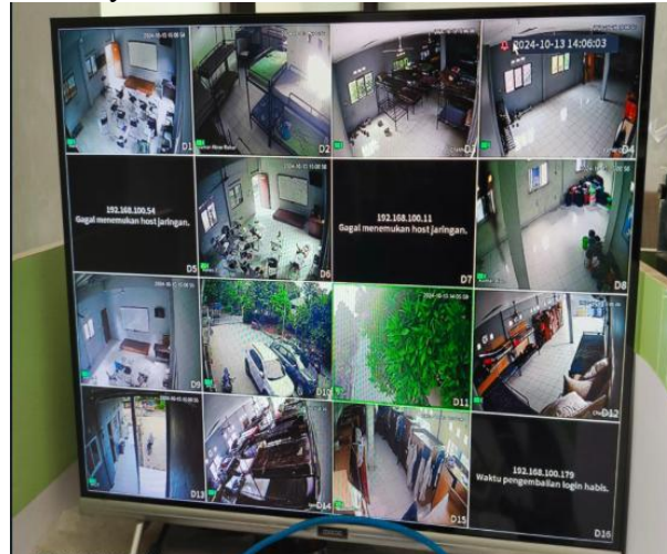
Gambar 1 kondisi CCTV yang tidak tampil
