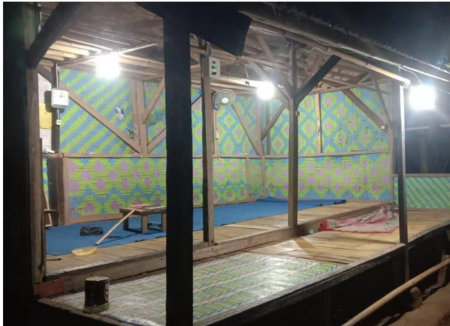
Gambar 3. Kondisi bangunan setelah pembaruan instalasi listrik
