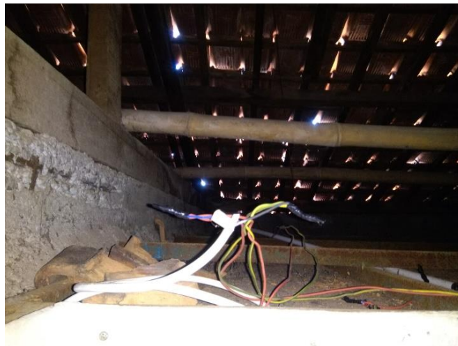
Gambar 2. Kondisi Instalasi sebelum kegiatan
