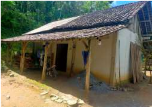
Kondisi Rumah Sebelum Mendapatkan Bantuan BSPS
