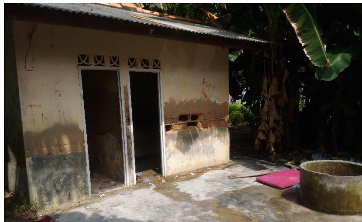
Gambar 6 : Kondisi unit MCK yang tidak digunakan oleh warga
