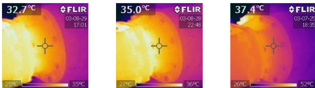
Gambar 18. Penyebaran Temperatur pada BCNDE1 pada Pemindaian 30 Menit Dengan Pembebanan Fully Open , 20°, dan 40°
