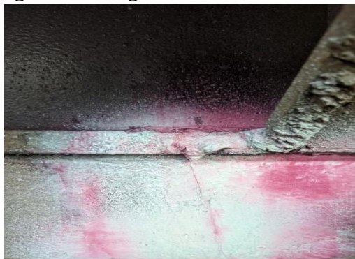
Gambar 2. Keretakan pada gerbong
