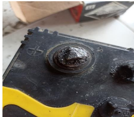
Gambar 2 Terminal Aki Mengalami kerusakan
