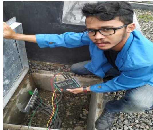
Gambar 6. Pengukuran Tahanan Pentanahan pada bak kontrol Tower BTS
