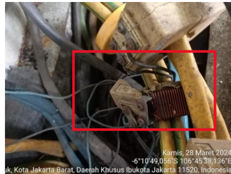
Gambar 5. Temuan trafo arus meleleh
