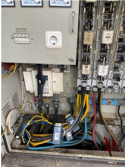
Gambar 7. Trafo arus baru terpasang
