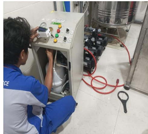
Gambar 8. Pemasangan alat monitoring debit air pada mesin reverse osmosis portable
