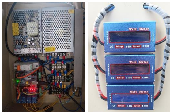
Gambar 5. Bagian Panel Kendali dan Pemantau
