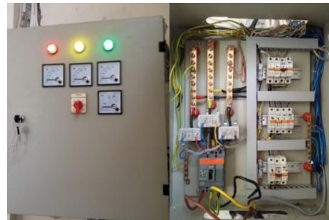
Gambar 4. Panel Distribusi 3 Fasa Masjid Baitussalam Tampak Luar (Kiri) dan Tampak Dalam (Kanan)
