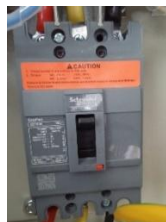
Gambar 19. MCCB Schneider Electric 50A
