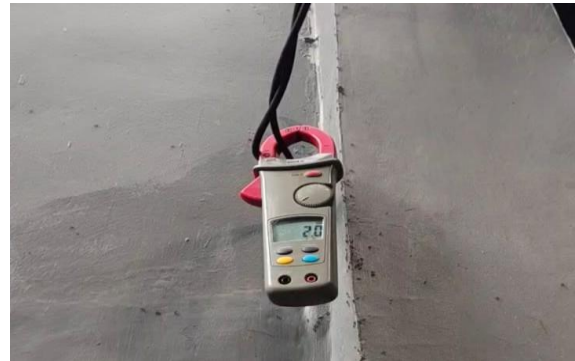
Gambar 9. Pengukuran Arus kWh Meter Prabayar Pada Kabel
