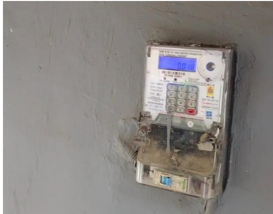
Gambar 10. Pengukuran Arus kWh Meter Prabayar Pada Display
