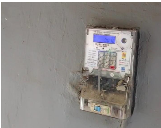
Gambar 10. Pengukuran Arus kWh Meter Prabayar Pada Display
