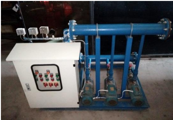
Gambar 6. Purwarupa Variable Speed Parallel Pump dengan 3 Pompa
