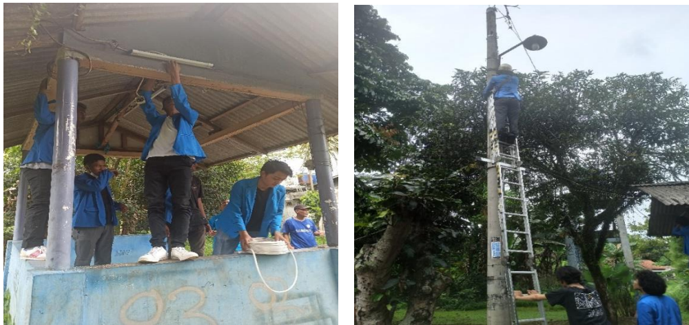
Gambar 4. Pemeliharaan Instalasi dan Penerangan Lampu Jalan
