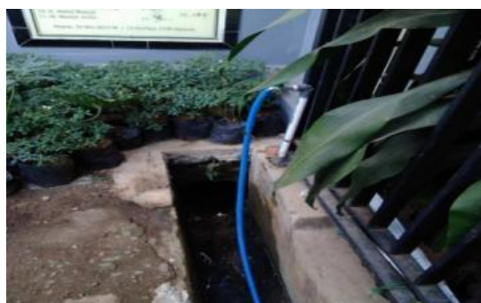
Gambar 6 Kondisi Saluran Air
