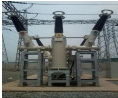
Gambar 2. Konstruksi aktual Hybrid GIS 170kV Hitachi
